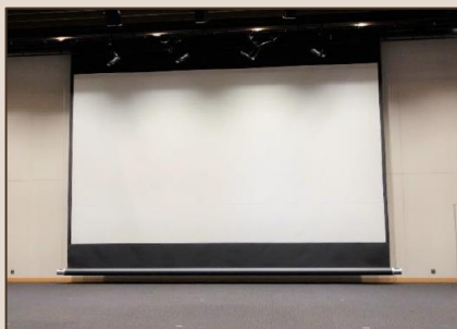
電動昇降式常設スクリーン
